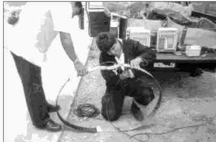
◦ Instalación del sensor ultrasónico
